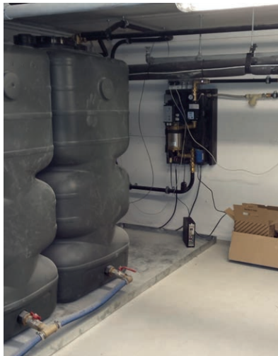
Figuur 20: Opslagtanks en het hemelwatersysteem. In de kelder van het kantoorpand.
